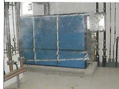
17.11.2008 Blockheizkraftwerk ist eingebaut
